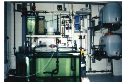
Die gesamte Technik, insbesondere die elektrischen Komponenten, sollten übersichtlich und sicher aufgebaut sein. Foto: AquaCare
