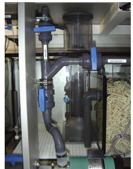
Ordentlich verlegte PVC-Rohre bieten ein Höchstmaß an Übersichtlichkeit und Sicherheit. Foto: AquaCare
