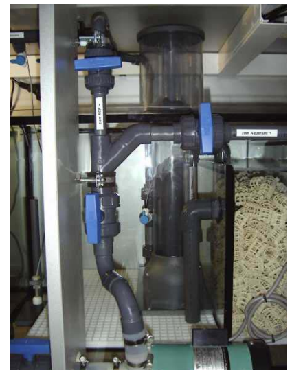
Eine ordentliche und stabile Verrohrung aus PVC ist Voraussetzung für einen sicheren Betrieb ohne Überschwemmungen. Foto: AquaCare
