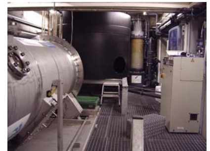
Denitrifikationsanlagen (RBR) mit anschließender Bakterienentfernung (ACF16.000VC) im Delphinarium Duisburg.
